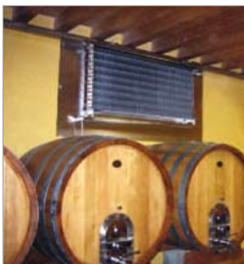
Sopra Un impianto di refrigerazione per le barricaie (settore vinicolo).
